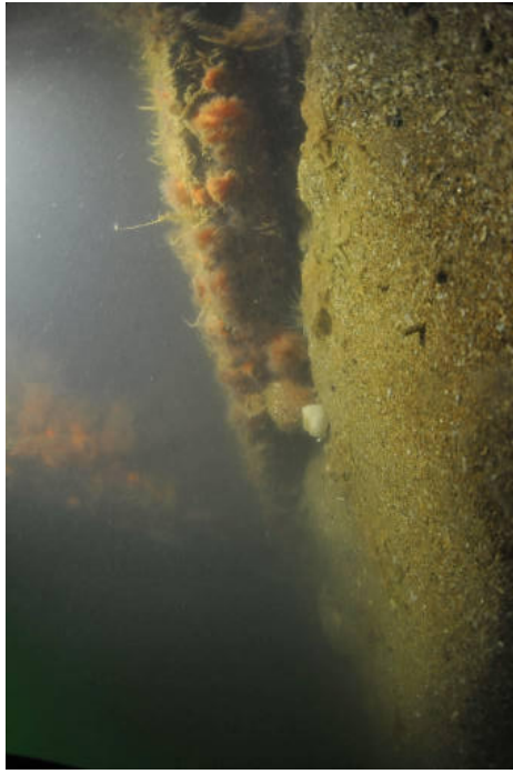
Peu d'affouillement au droit des modules
